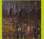
Dégradation du bâti (humidité, moisissures)
