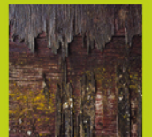
Dégradation du bâti (humidité, moisissures)
